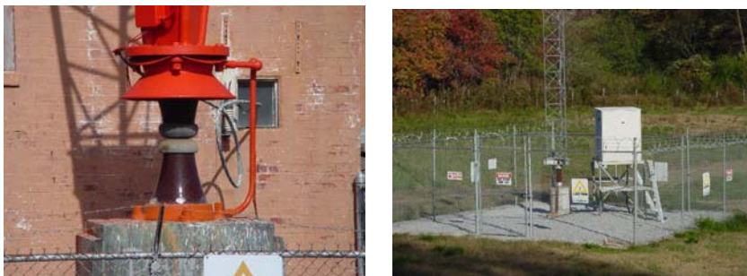
Fig. 10.28. Aisladores en la base de antenas monopolo para AM.
